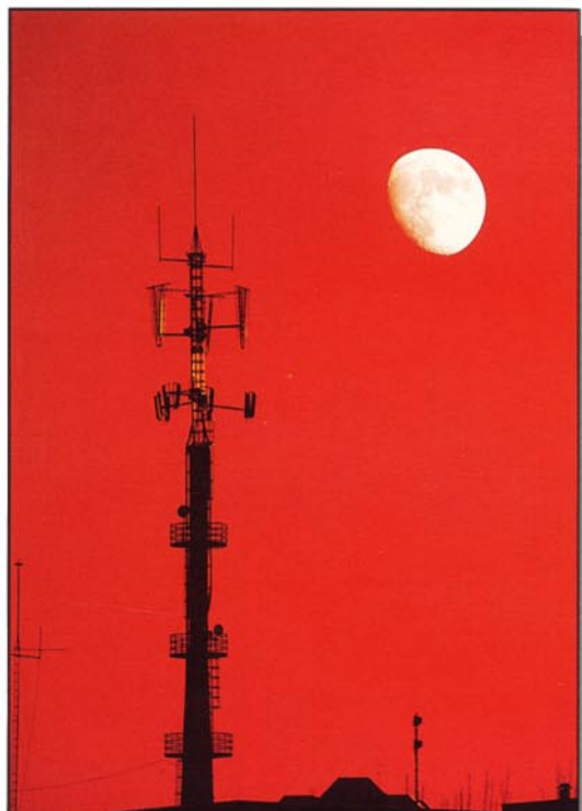
Antena de la central digital de Albéniz (Madrid)
