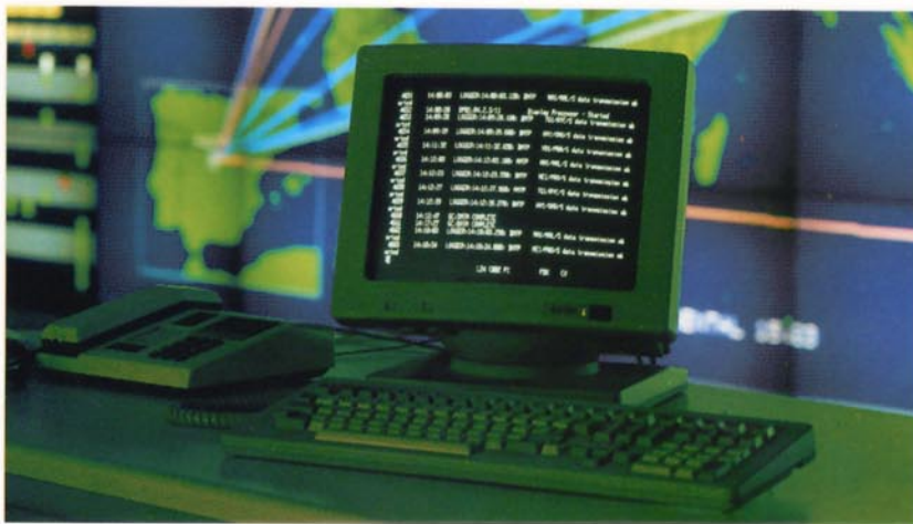
Centro de Gestión Dinámica de Red de la central internacional de Alcobendas, Madrid.
