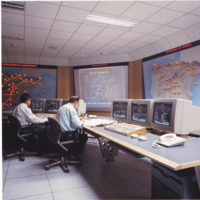
Sala de control de telecomunicaciones del edificio central de Campsa, en Madrid.
