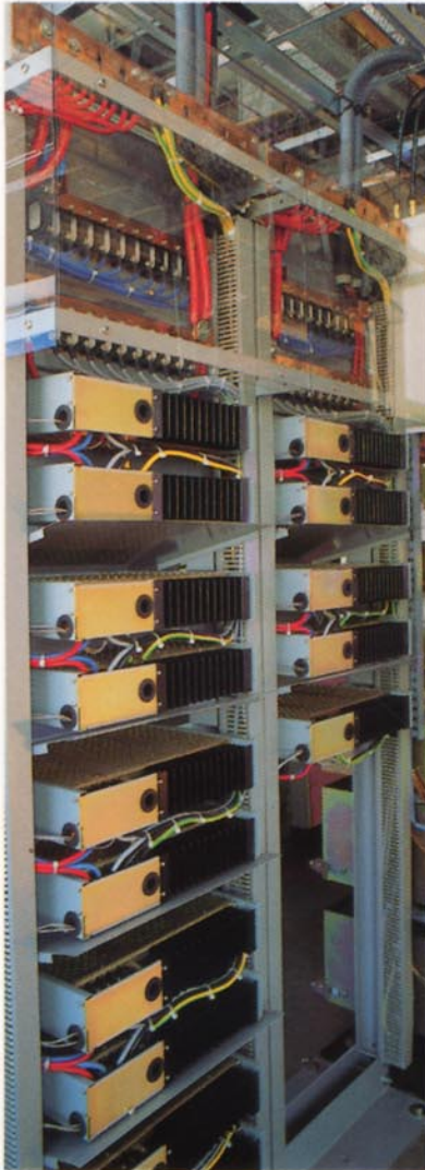
Detalle de las instalaciones de telefonía móvil en la Central de Cartuja-Sevilla.
