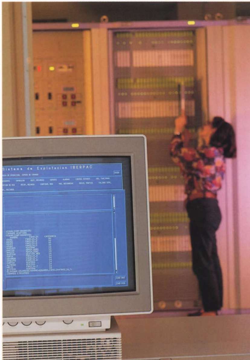
Equipo de la Red Iberpac instalado en la Central Norte, de Madrid.
