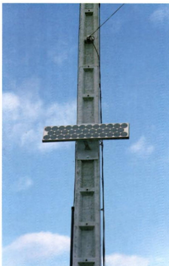
Detalle de equipo de Telefonía rural.
