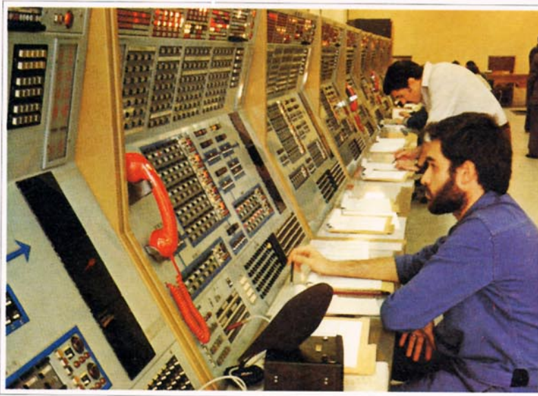
Consola del Centro de Conservación Dirigida instalado en la Central de Ríos Rosas en Madrid.
