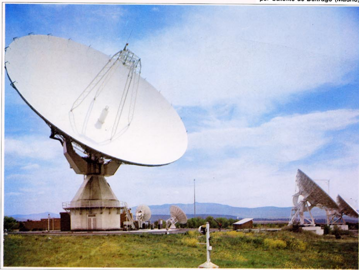
Panorámica de las cinco antenas instaladas en la Estación de Comunicaciones por Satélite de Buitrago (Madrid).
