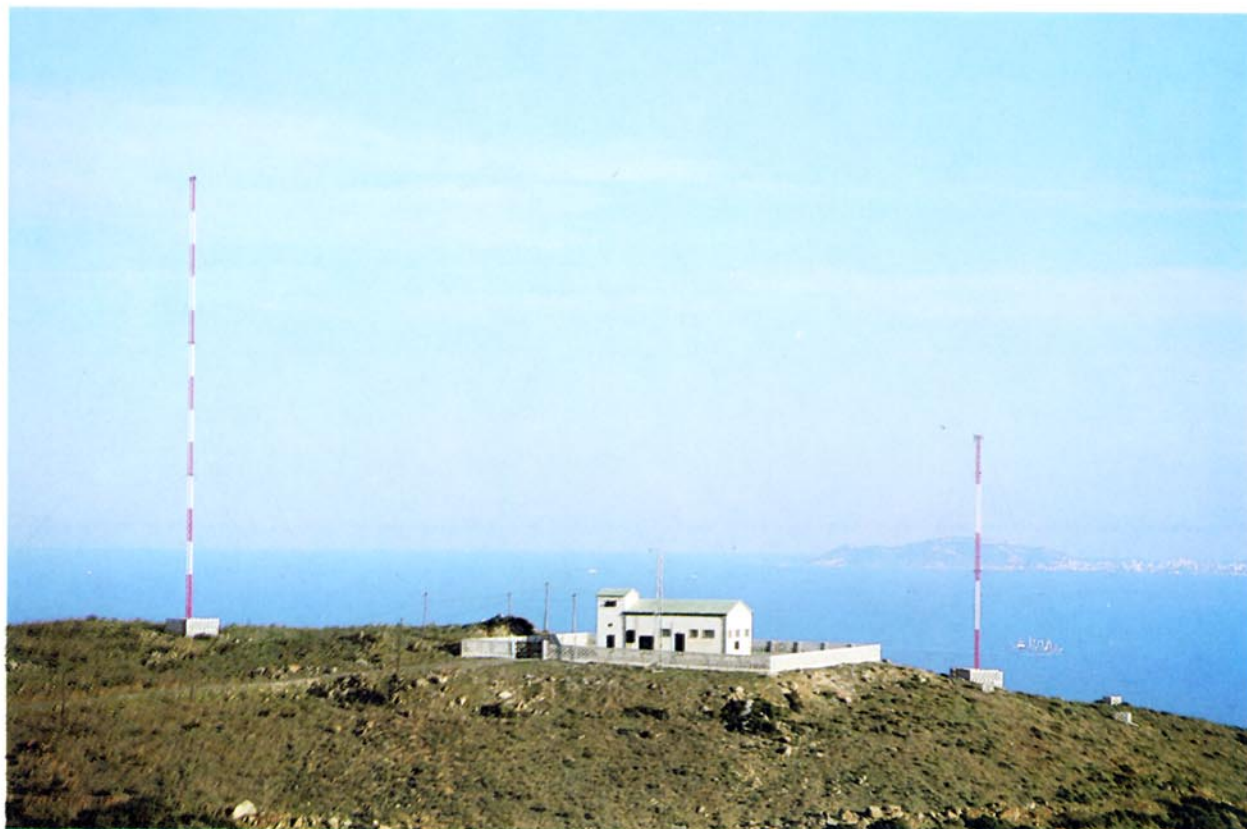
Nueva Estación Costera de VHF instalada en Tarifa (Cádiz).
